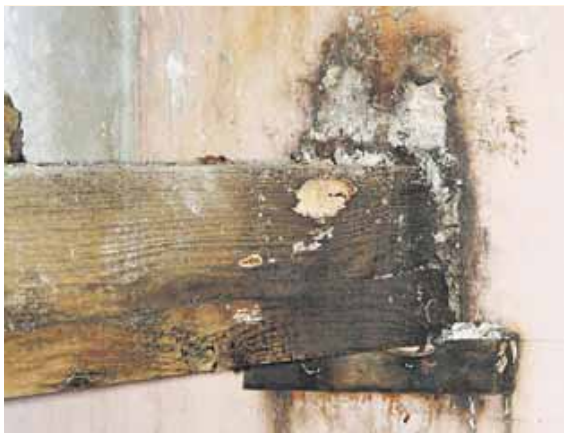
Schäden im Stäbli-bad: Eindringende Feuchtigkeit hat auch die Stützbalken angegriffen, die das Schwimmbecken sichern.
