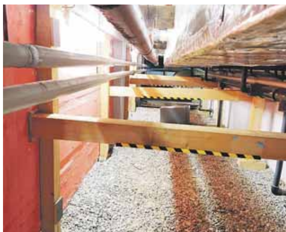
Im Untergeschoss muss das Schwimmbecken (rote Wand links) mit Balken gesichert und gestützt werden. Foto: job
