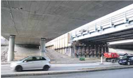
Die Kreuzhofbrücken (links) aus dem Jahr 1966 sind marode und werden abgerissen. Foto: job
