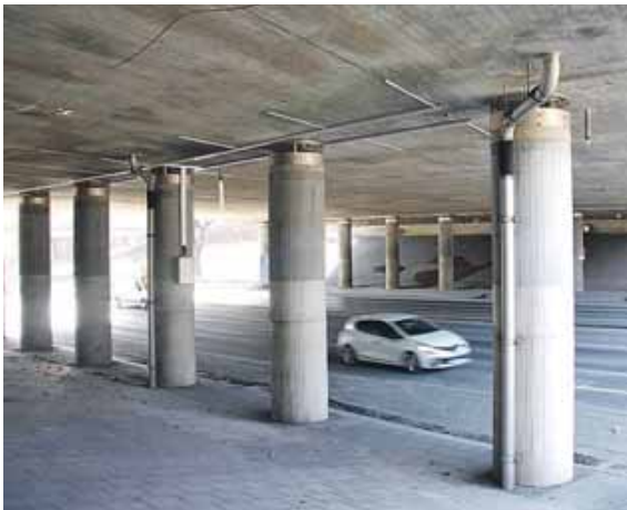
Die Kreuzhofbrücken wurden 1966 gebaut. Jetzt müssen sie abgebrochen werden. Foto: job
