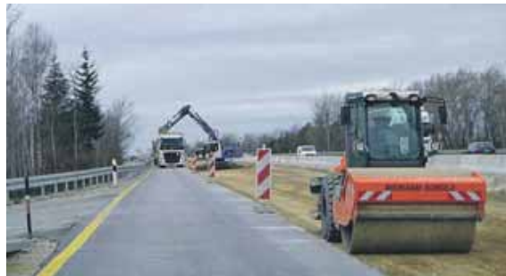
Die Baustelle auf der A 92 bei Moosburg stellt die Verkehrsteilnehmer auf eine harte Geduldsprobe.
