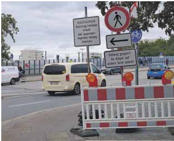
Laut Baureferat werden die Bauarbeiten an der Friedenheimer Brücke noch bis Mai andauern. Foto: Beatrix Köber
