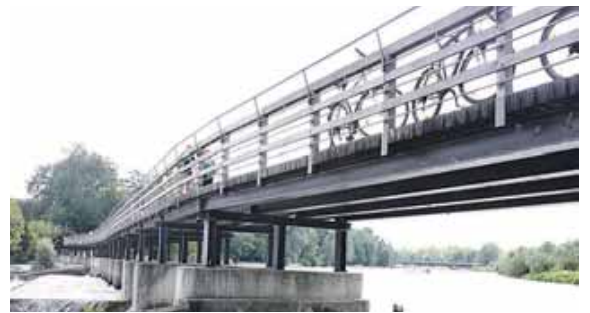
Der Flauchersteg verbindet die Stadtbezirke Sendling und Untergiesing-Harlaching miteinander. Er ist 340,50 Meter lang und vier Meter breit. Foto: job
