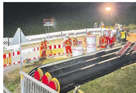
»Person verschüttet« hieß es im Juli an einer Baustelle in Anglberg. Foto: FW Zolling
