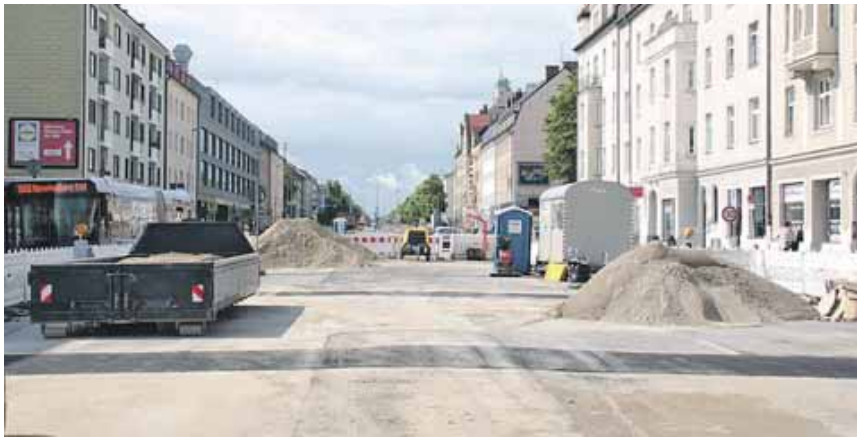
Die Fürstenrieder Straße: Damit schnell gebaut werden kann, wurde ein großes Baufeld zu Lasten des Verkehrs freigemacht.
